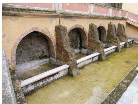
Bassins de décantation
